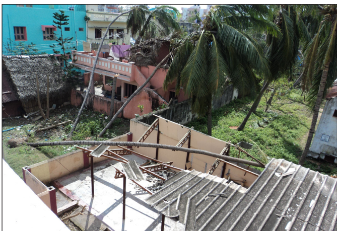
«Les effets d'un cyclone sur le préau de l'atelier»
